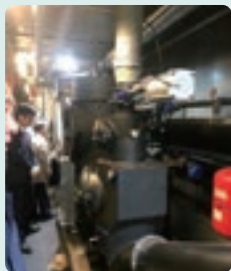
▲木質チップ製造施設
