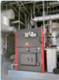
▲バイオマスボイラー
