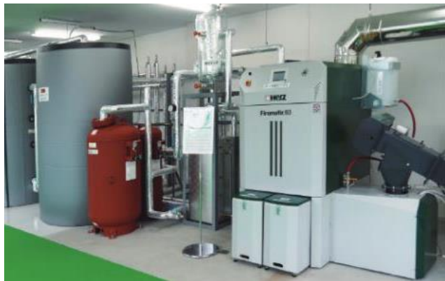
←チップボイラー (提供：緑産(株))
