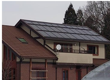
池田町内太陽光パネル
