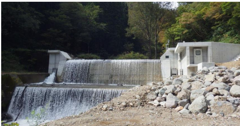
小水力発電取水口
